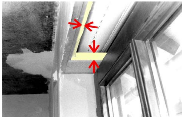
Der Rollladenkasten, dessen inneres mit der kalten Außenluft in Verbindung steht, sollte möglichst gut gedämmt sein. Bei diesem Kasten ist die Dämmung nachträglich angebracht worden. Im Neubau sind außen vorgesezte Kästen die bessere Lösung
