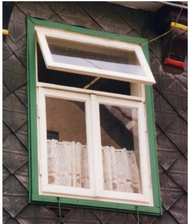
Vermeidbare Energieverluste entstehen Jahr für Jahr durch diese einscheibenverglaste Fenster.
