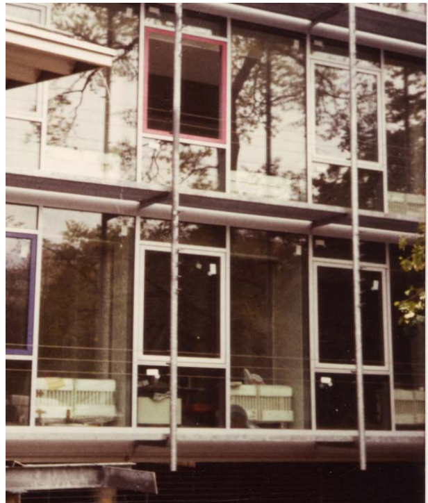
Bei diesem 1992 errichteten Bürohaus in Südhessen wurden mehr als 50 Heizkörper ohne Abdeckung direkt vor die Verglasung gesetzt.
