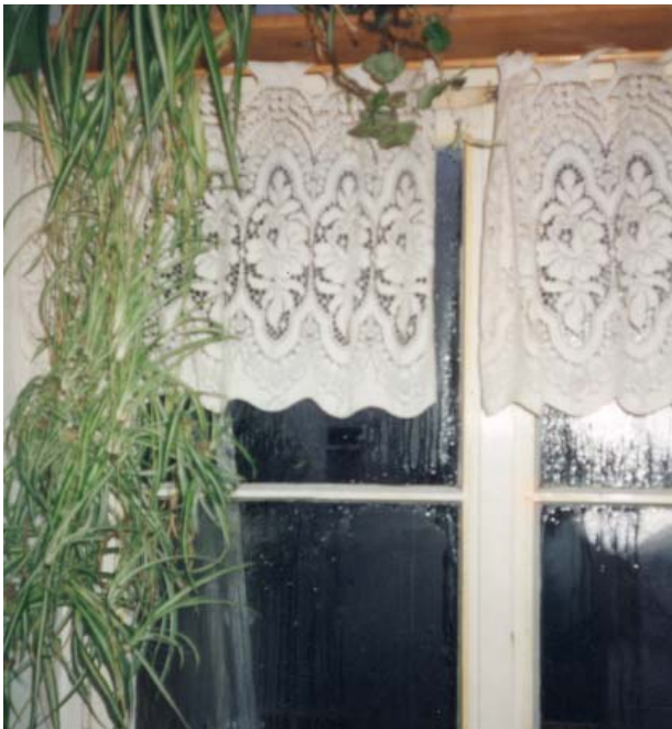
Ablaufendes Kondenswasser an einem einfach verglasten Fenster
