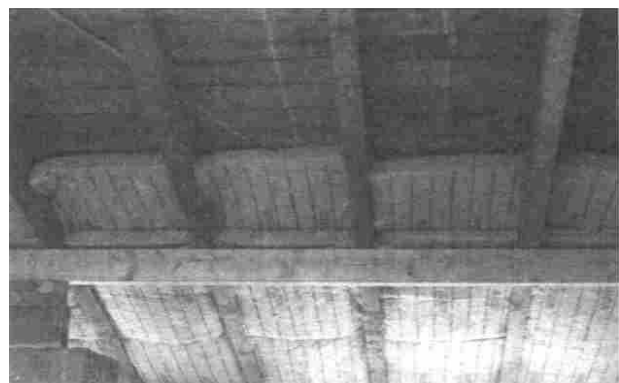
Hier sind 20 cm Dämmstoff zwischen den Sparren des Daches angebracht. Sie werden noch durch 5 cm Dämmung unter den Sparren ergänzt (Gipskarton-Verbundplatte).
