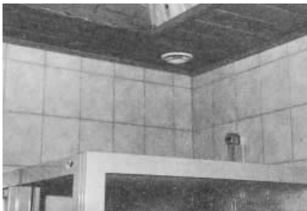
Abb. 3: Abluftventil im Bad
