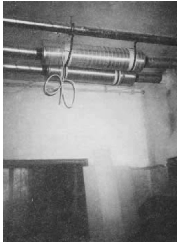
Abb. 5: Schalldämpfer im Rohrnetz einer Zu-/Abluftanlage. Das Rohrnetz muss aus glatten Materialien mit geringem Strömungswiderstand bestehen (hier: Wickelfalzrohr).
